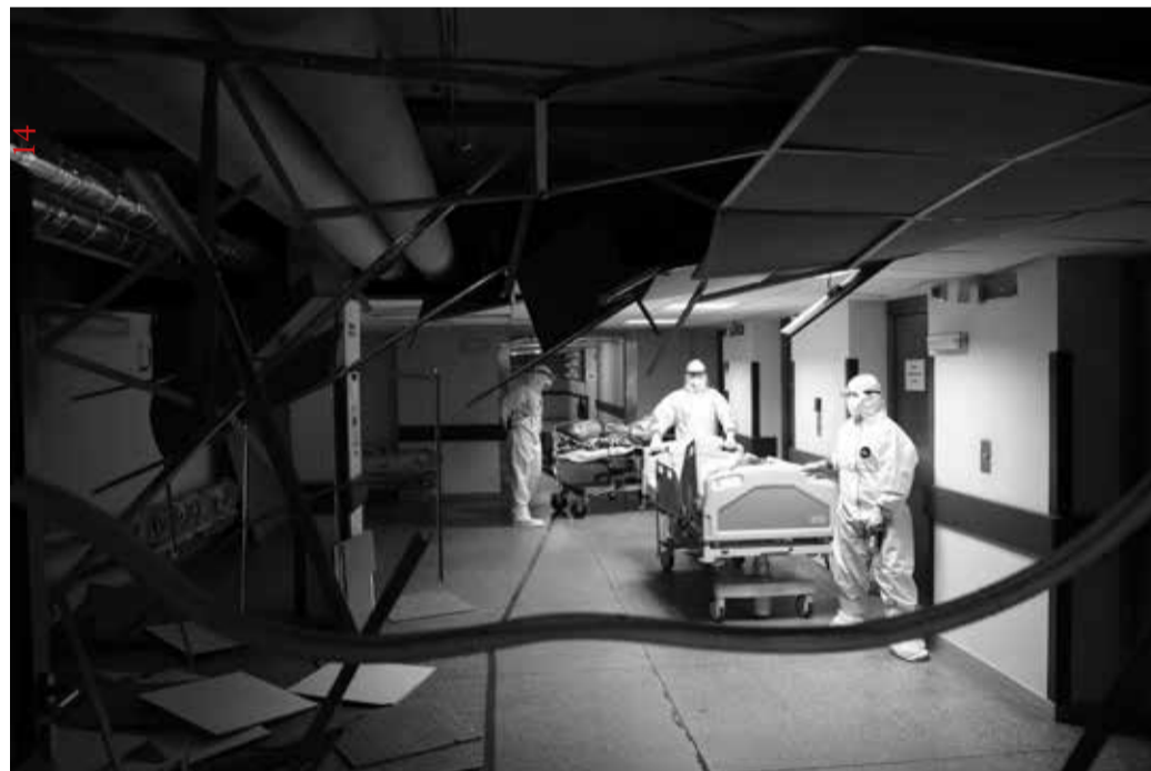
5 | Korytarze w piwnicy szpitala zakaźnego pełnią ważną rolę głównej traktacji komunikacyjnej w „strefie brudnej”.
